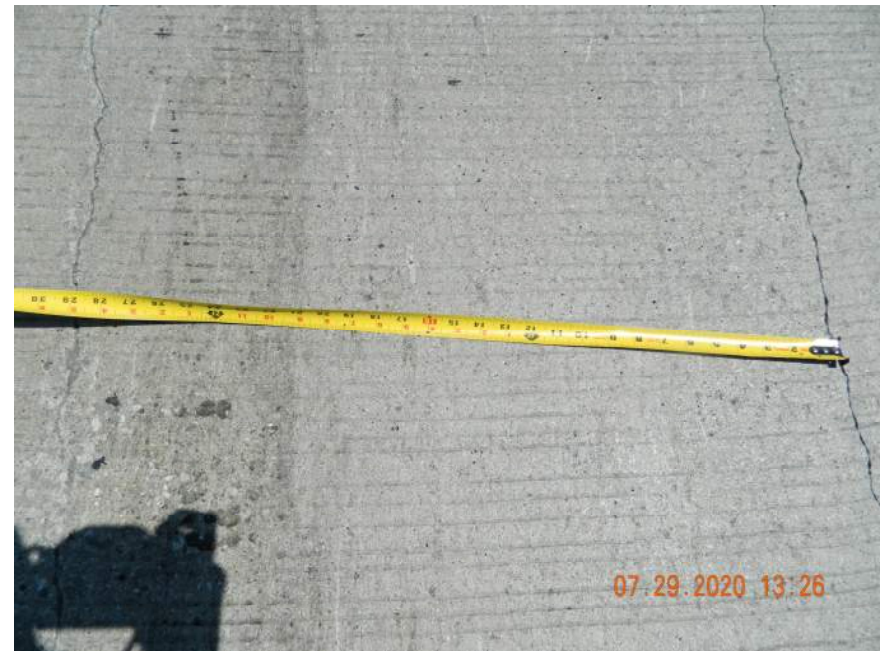
LONGITUDINAL CRACKING - TYP. SPACING
